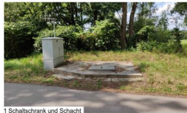
1 Schaltschrank und Schacht
